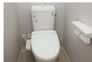
温水洗浄便座付きトイレ
